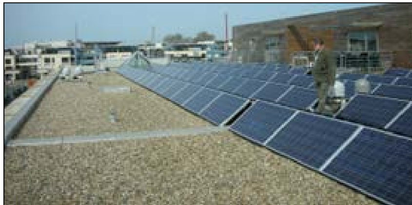
Figure 41: Intégration des capteurs en toiture terrasse.
