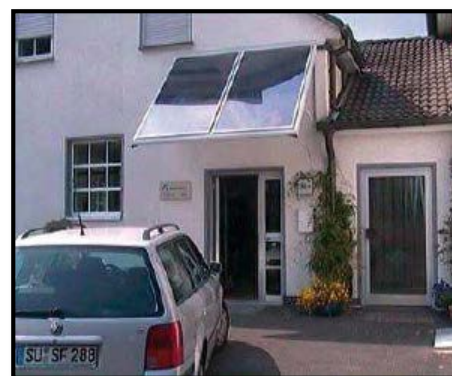
Figure 45: Les capteurs solaires en décrochement de façade.
