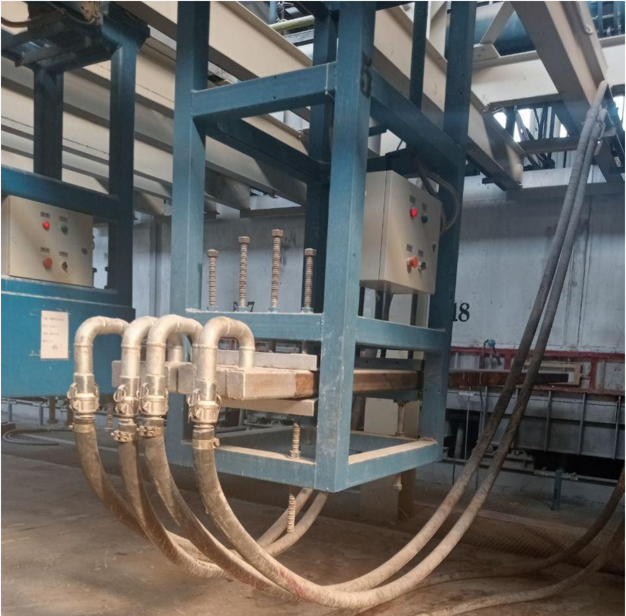
Figure II.13: Vue extérieure du refroidisseur au sein du MFG.
