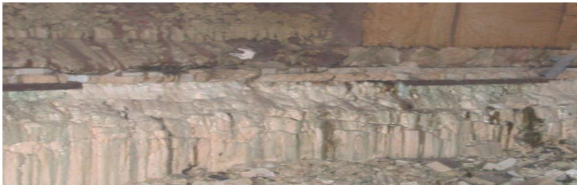
Figure III.9 : Erosion de brique AZS.
