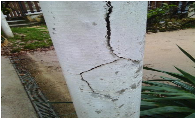
Figure II.18. Fissuration de la fissure dans Un poteau vertical
