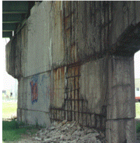
Figure I.11. Agression du béton par activité des chlorures. [24]
