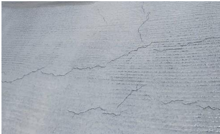
Figure II.20. Fissure de faïençage (séchage précoce, retrait plastique)
