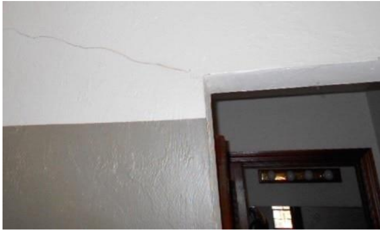
Figure II.17. Fissure diagonale dans une cloison sèche.
