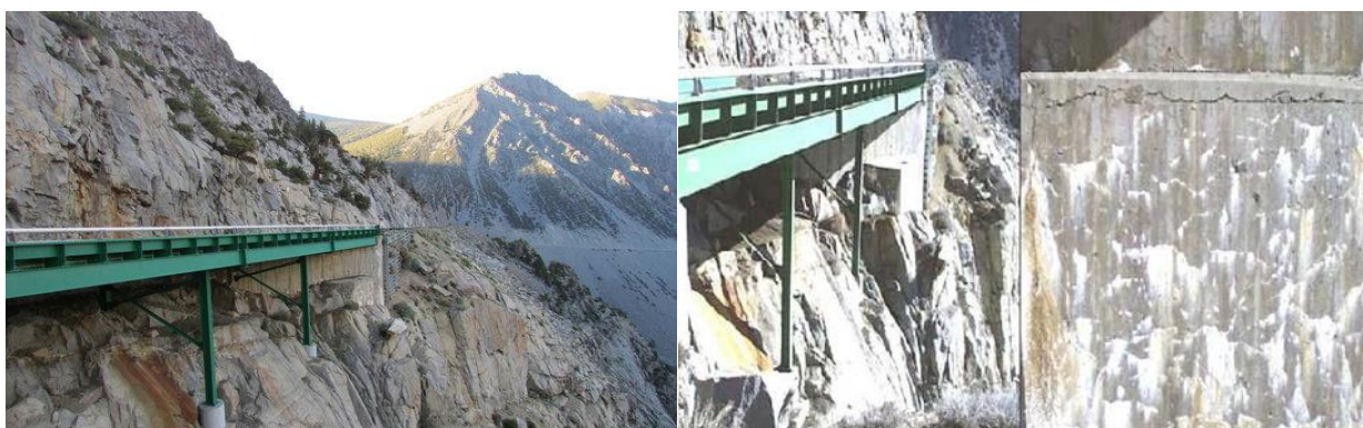
Figure I.7. Des cas pathologiques d'éléments en béton avant et après contact de sulfate. [18]
