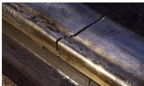
Figure VI. 9: Cas d'un rail fissuré [21]
