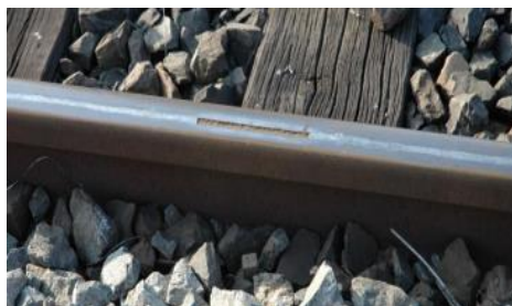
Figure VI. 8: Cas d'un rail avarié [21]
