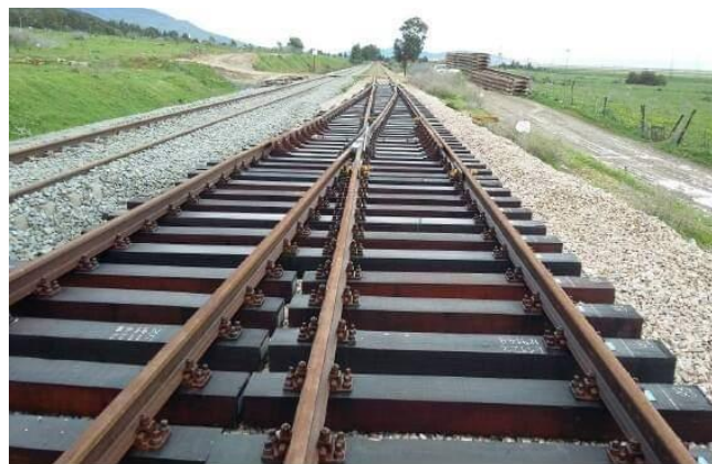
Figure VI. 11: Voie avec travers en bois
