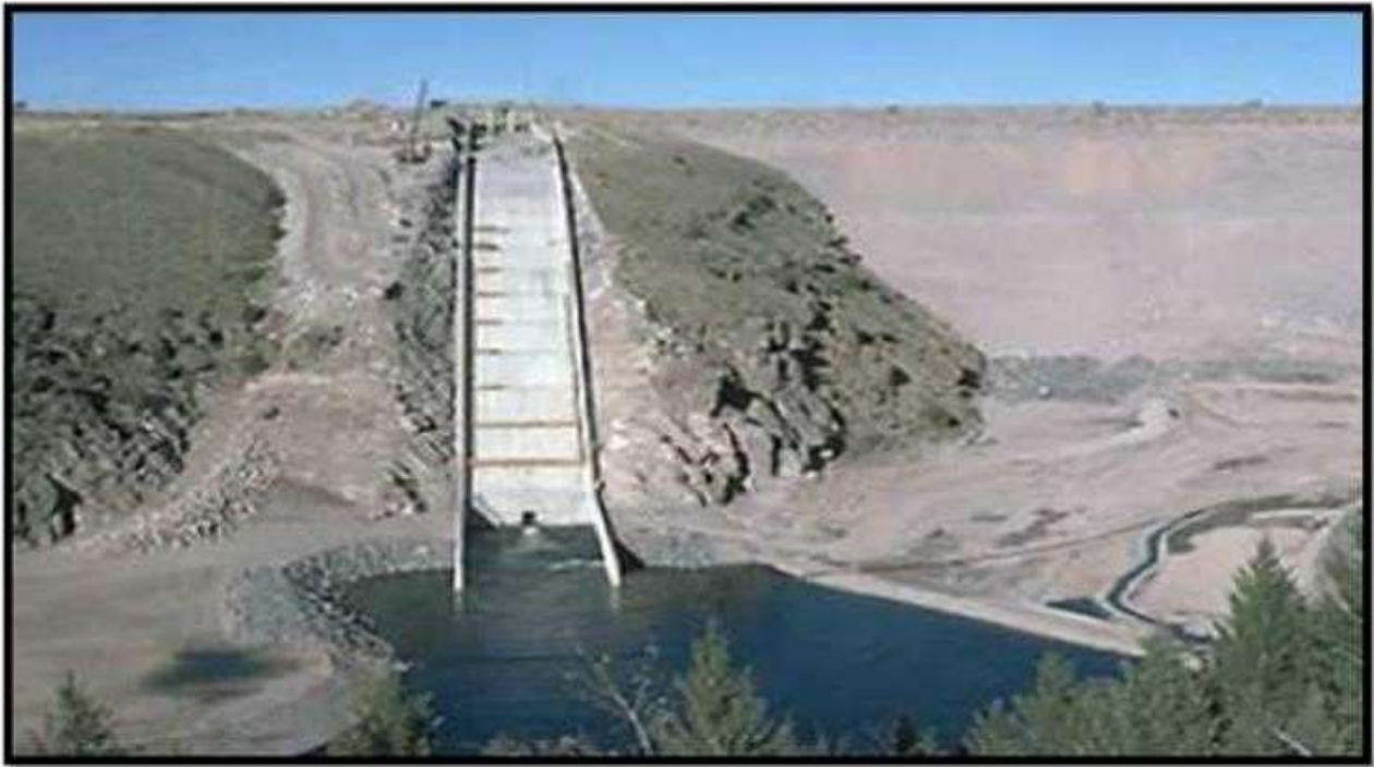
Figure 2.11 : Photo de vue du barrage de Teton (rive nord proche de l'évacuateur).
