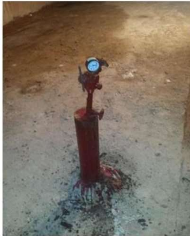
Fig. 3.12 : (PON) à manomètre dans la galerie du barrage de Zit El Emba d'un drain.
