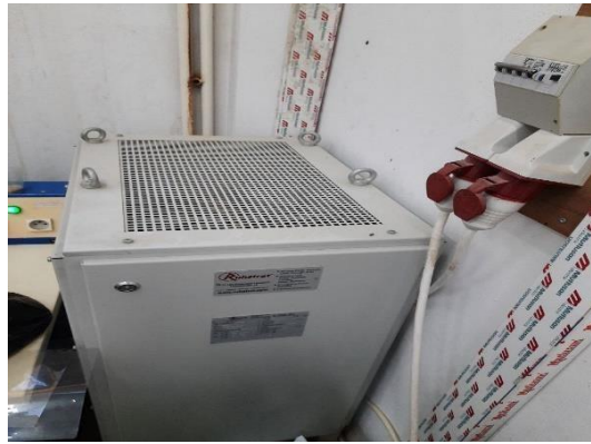
Figure : IV.5 : Autotransformateur.
