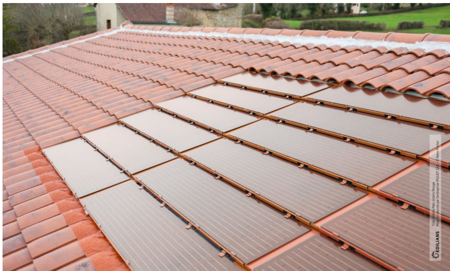
Fig26- Le PV pour les tuiles Source : http:// www.suisseenergie.
