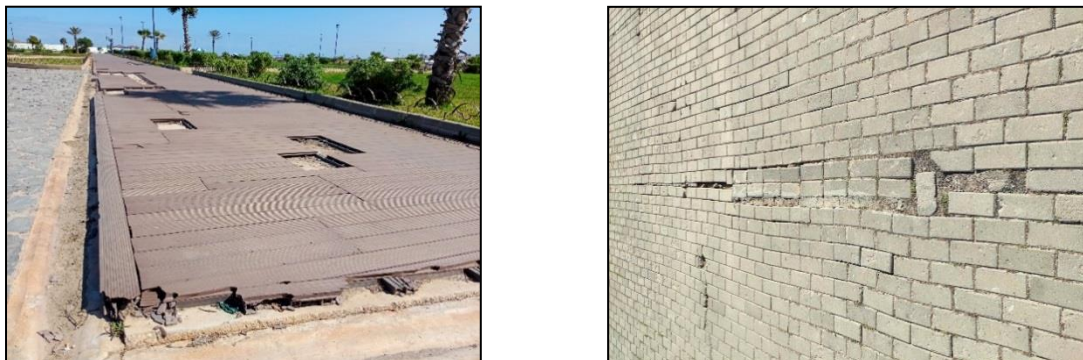
Figure V-12: Pavage mal entretenu. (Source : Auteur, 2019)
