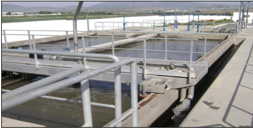
Figure 12 : Bassins de dessablage, déshuilage et dégraissage.
