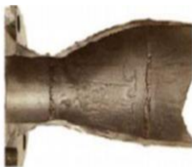
Figure I.6 : Corrosion-érosion dans une zone turbulente [Kherraf.S ; 2008].
