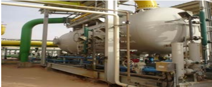
Figure II.3 : Séparateur HP 10-V-27000 de centre GS1.
