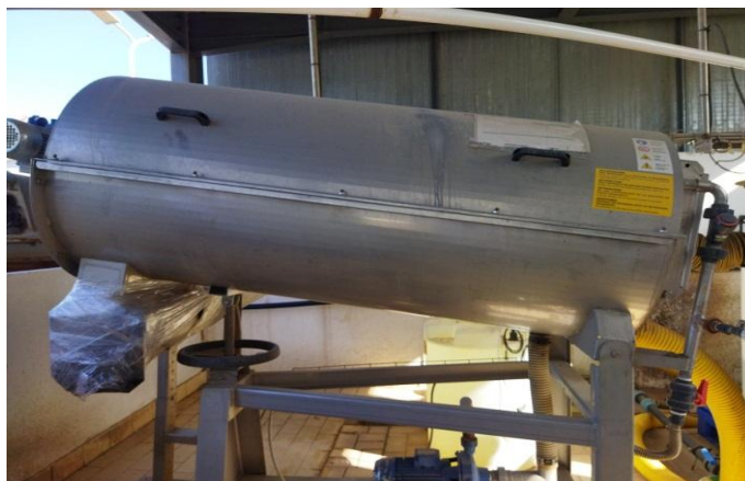
Figure 14 : Tank des effluents
