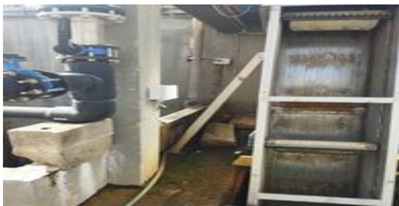
Figure 9 : Dégrillage (gros matière)
