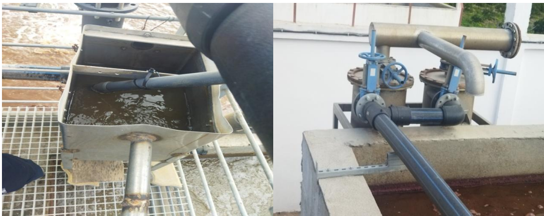
Figure 13 : Filtration de sable
