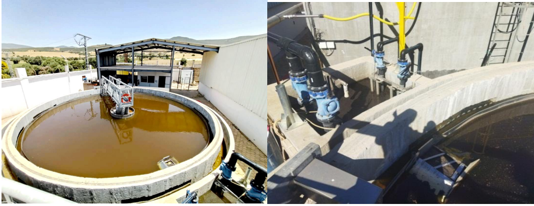
Figure 12 : Les cuves de décantation
