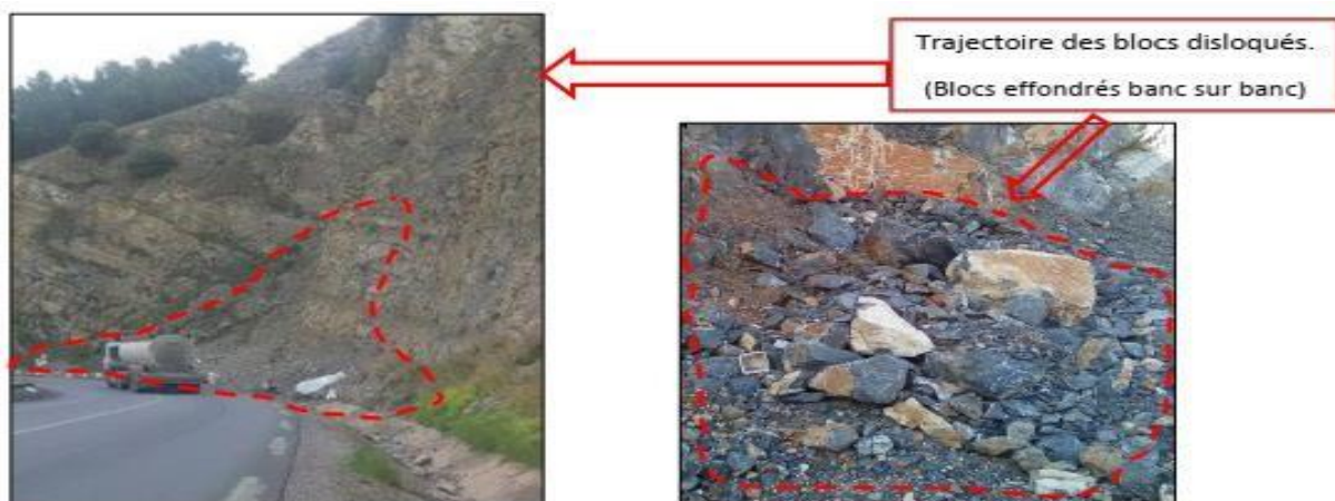
Figure.IV.8 Exemple de blocs effondrés du paquet rocheux et tombés sur la plateforme
