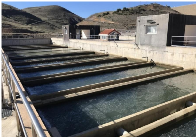
Figure 30 : Les filtres à sable de la station El Maouane.
