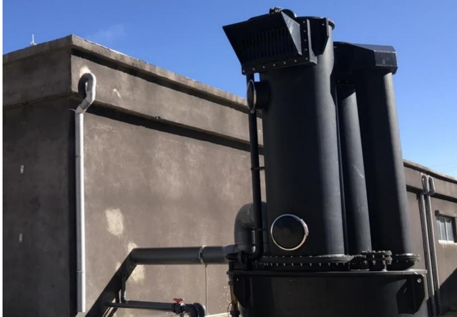
Figure 26 : Pompe d'injection du \text{Cl}_2 de la station El Maouane.
