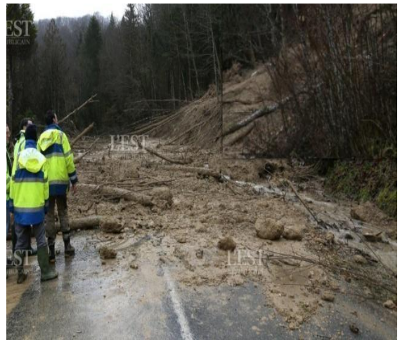
Figure IV- 4 : affouillement du pied de talus
