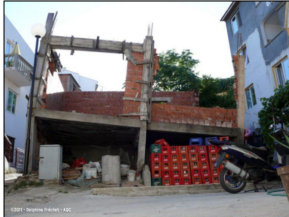
Figure III.1 : Rupture des poteaux sous l'effet d'une charge excessive.
