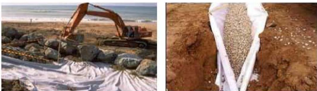
Figure II.19. L'utilisation pour filtration
