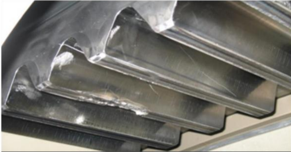
Figure I.9 Défaut de fissure
