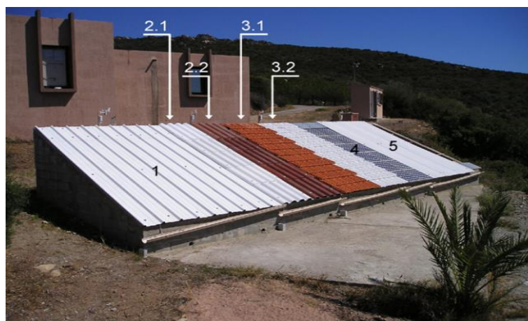
Figure III.24 : Plate-forme de toiture expérimentale de climatisation de 48 \text{ m}^2 avec 5 matériaux différents : PSS : 1 ; FC : 2 (2,1 et 2,2 pour les revêtements blancs et incolores) ; TCT : 3 (3,1 et 3,2 pour les revêtements blancs et incolores) ; Modules photovoltaïques : 4 et CS : 5 (Muselli, 2010)
