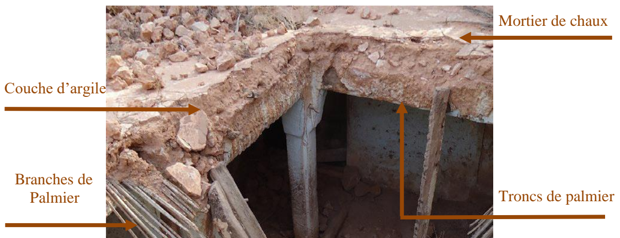
Figure II.29 : Photo réelle montrant les différentes couches de toit en palmes et argile
