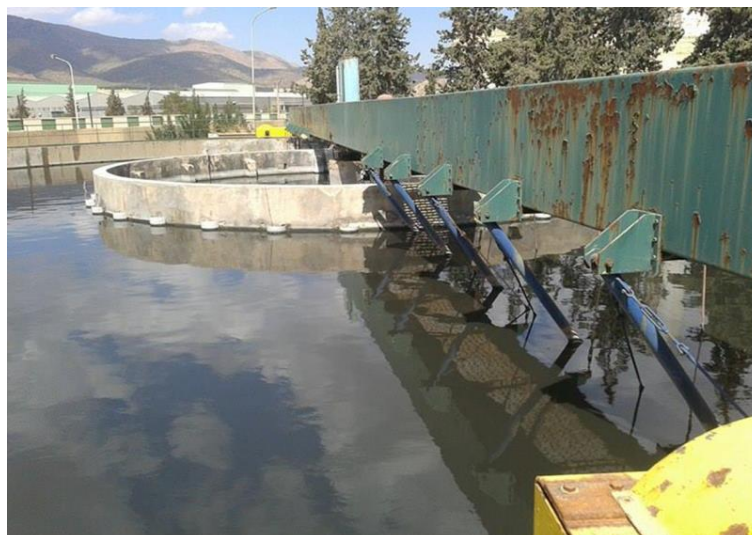
Figure 0-10 : Décanteur flocculateur raclé de la station d'épuration du complexe textile de Batna
