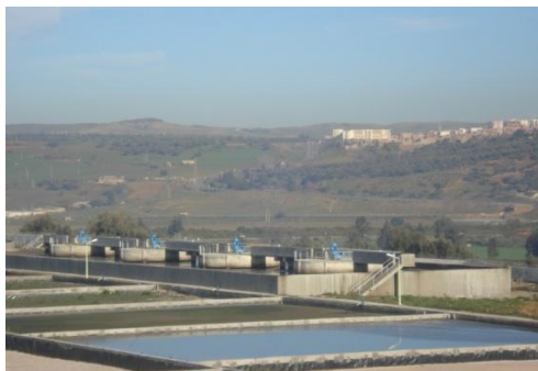
Bassin de désinfection
