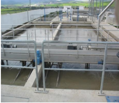
Bassins de dessablage, déshuilage et dégraissage
