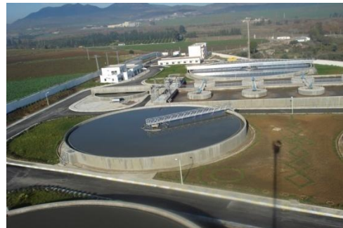
Bassin de clarification
