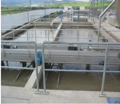
Bassins de dessablage, déshuilage et dégraissage
