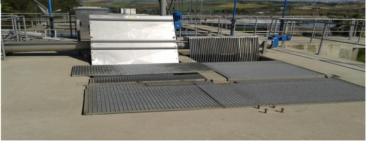
Figure 11 : Dégrilleur (STEP Guelma, 2015).
