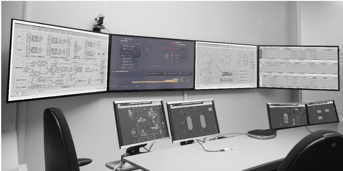
Figure III.8. Salle de contrôle (stations HIS)
