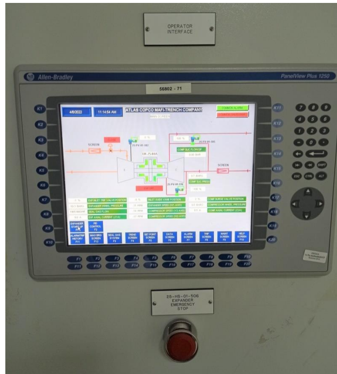
Figure IV.2 l'HMI de l'armoire du PLC (UCP)
