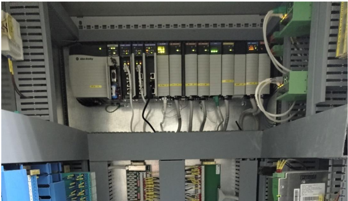
Figure IV.1. L'armoire du PLC Allen-Bradley du turbo-expander
