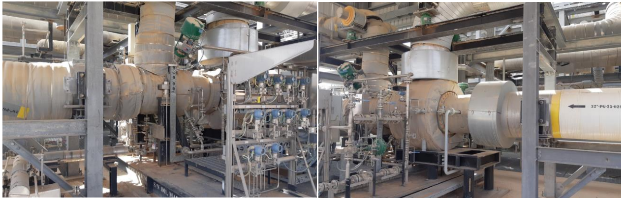
Figure II.2 l'ensemble turbo-expander/ compresseur Atlas Copco MAFI-TRENCH
