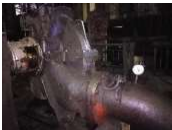
Figure.III.4 : La pompe G29
