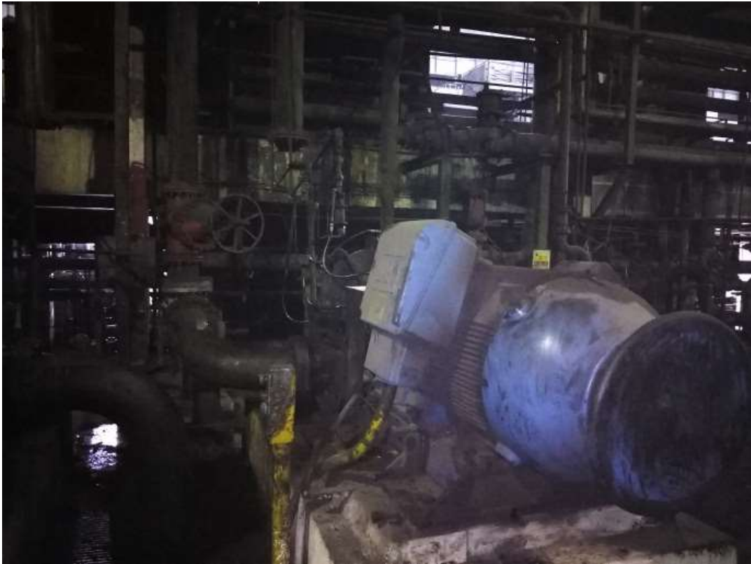
Figure.VI. 6 : Photo réelle de la pompe centrifuge 300/LNN 750
