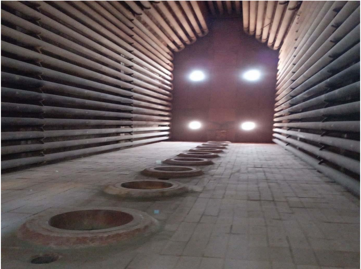
Figure II.2. Vue des brûleurs à l'intérieur
