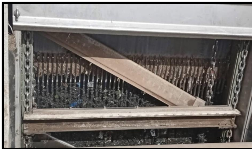
Figure II.3 : Dégrillage (STEP Guelma 2022).
