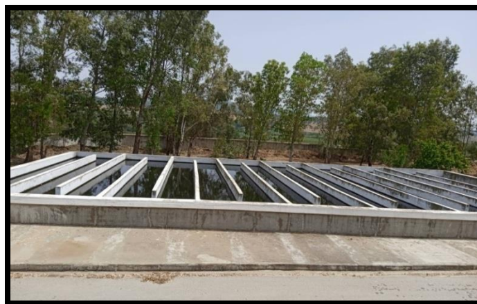
Figure II.8 Bassin de désinfection (STEP Guelma 2022)
