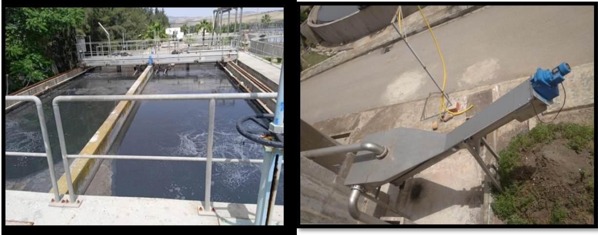
Figure II.4 : Dégrossissement – Déshuilage (STEP Guelma 2022)
