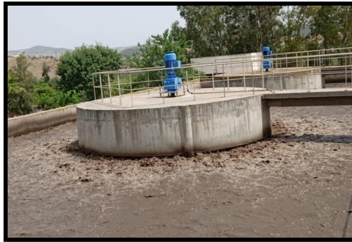
Figure II.6 : Bassin d'aération (STEP Guelma 2022).
