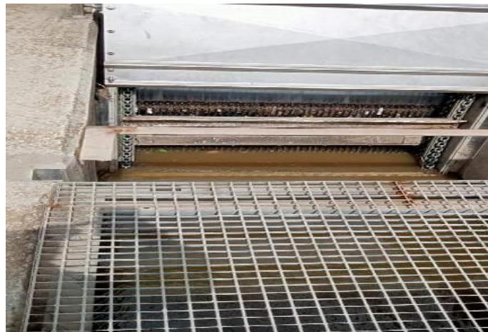
Figure 7 : Dégrillage STEP Guelma.
