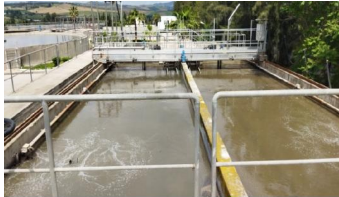
Figure 8 : Dessablage, Dégraissage STEP Guelma.
