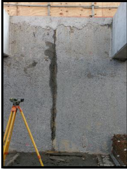
Figure II.34 : Défaut d'étanchéité des joints entre les panneaux de paroi moulée.
