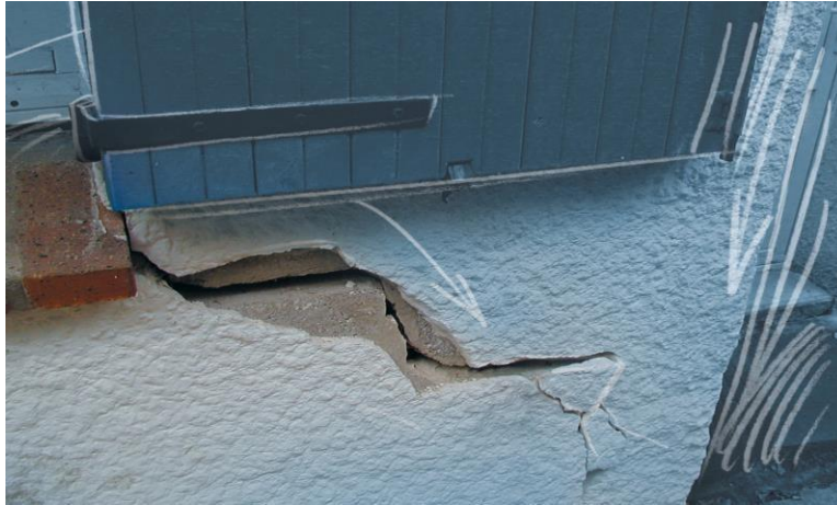
Figure I .15 : Maison fissurée à cause de la retraction et du gonflement de l'argile (Pas-de-Calais, 2003). © BRGM - P. Burchi
