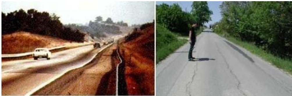
Figure I.14 : Le gonflement affecte la route.
