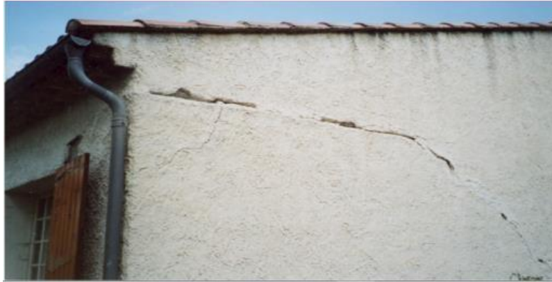
Fig. 1.13 Maison fissurée en raison des mouvements de terrain induits par la rétractation Et le gonflement du sol argileux. © BRGM
