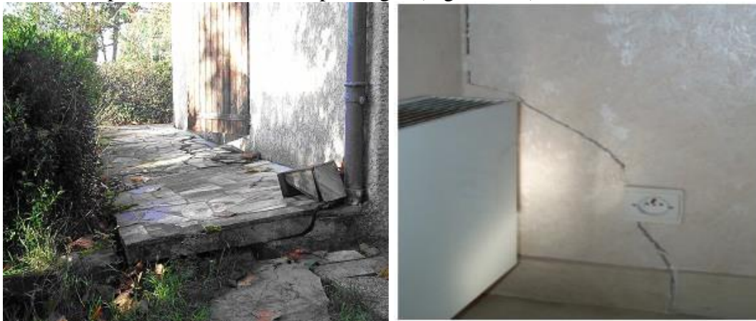
Fig. 1.12 Désordres de la structure au cours des périodes de sécheresse (Région bordelaise, Ref.).
