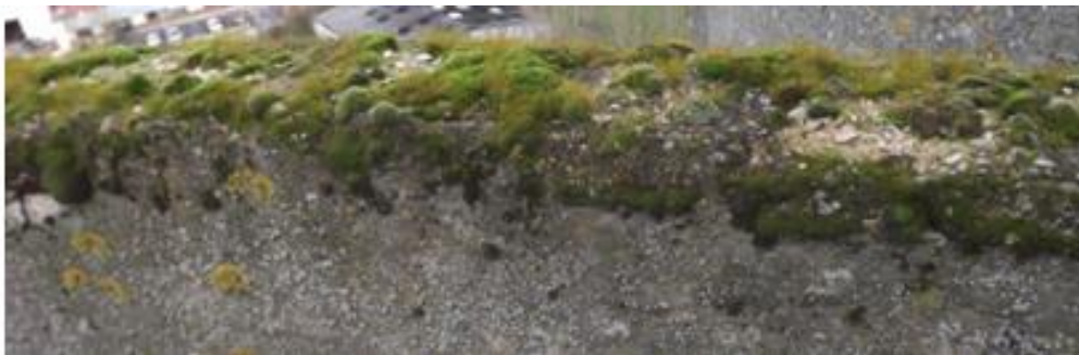
Figure 3.6 : L'acrotère n'avait pas été protégé par une couvertine [6].
