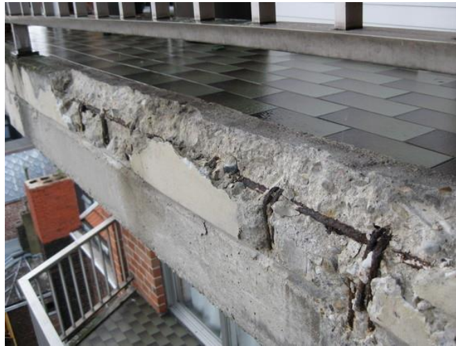
Figure 3.1 : Bords de balcon éclatés par carbonatation des bétons [6].
