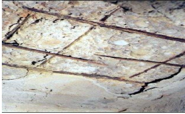
Figure 3.16 : Corrosion des armatures d'une dalle [21].
