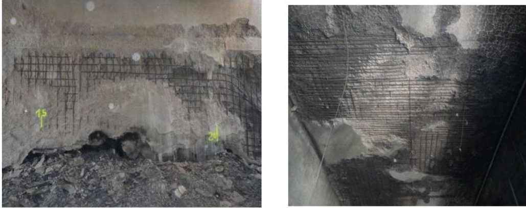
Figure 3.10 : Dégâts observés suite à un incendie [19].
