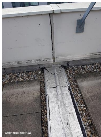
Figure 3.4 : Absence de joint de fractionnement sur l'acrotère [14].
