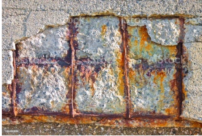
Figure 3.5 : Eclatement du béton de la façade induisant une corrosion des aciers [15].
