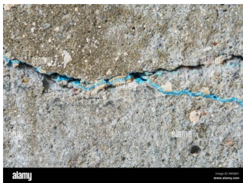
Figure 3.15 : Fissure d'une dalle [20].
