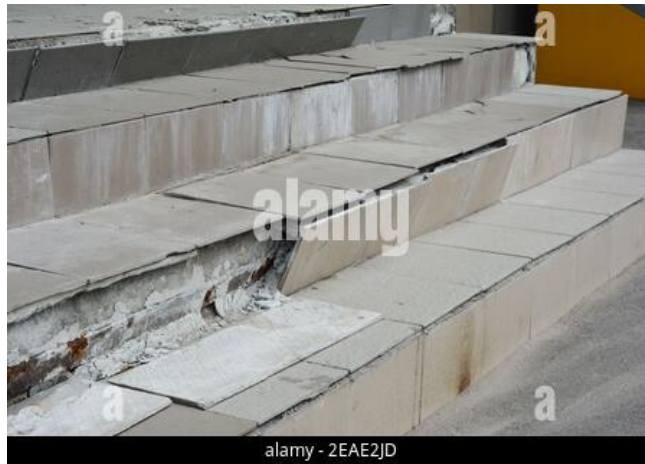
Figure 3.7 : Escalier en béton ancien endommagé [17].
