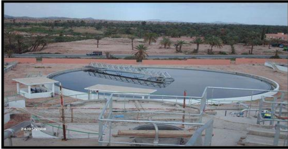
Figure 4: Le bassin circulaire de la décantation primaire (Azzouzi, 2010).
