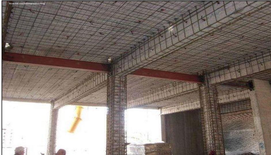
Figure I.10 : Structure renforcée par béton armé.
