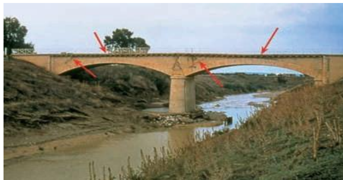
Figure I-1 : Tassement de la pile médiane d'un pont due à l'affouillement local de sa fondation
