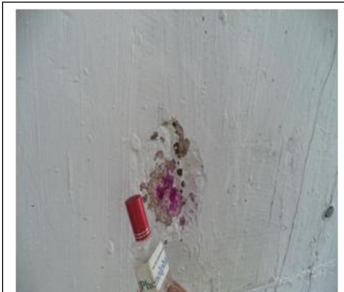
La solution de phénolphthaléine se colore même à moins de 10mm. Béton non carbonaté.
