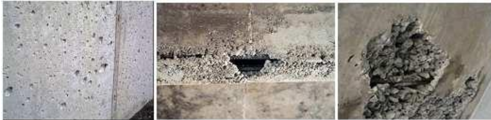
Figure I-22 : Défaut de mal exécution des travaux
