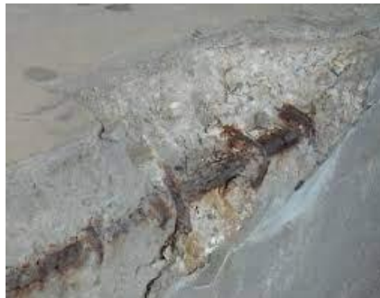
Figure I-16 : Piqure profonde causée par une attaque de chlorure
