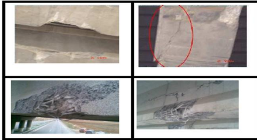
Figure I-6 : Les différentes dégradations causées par le choc
