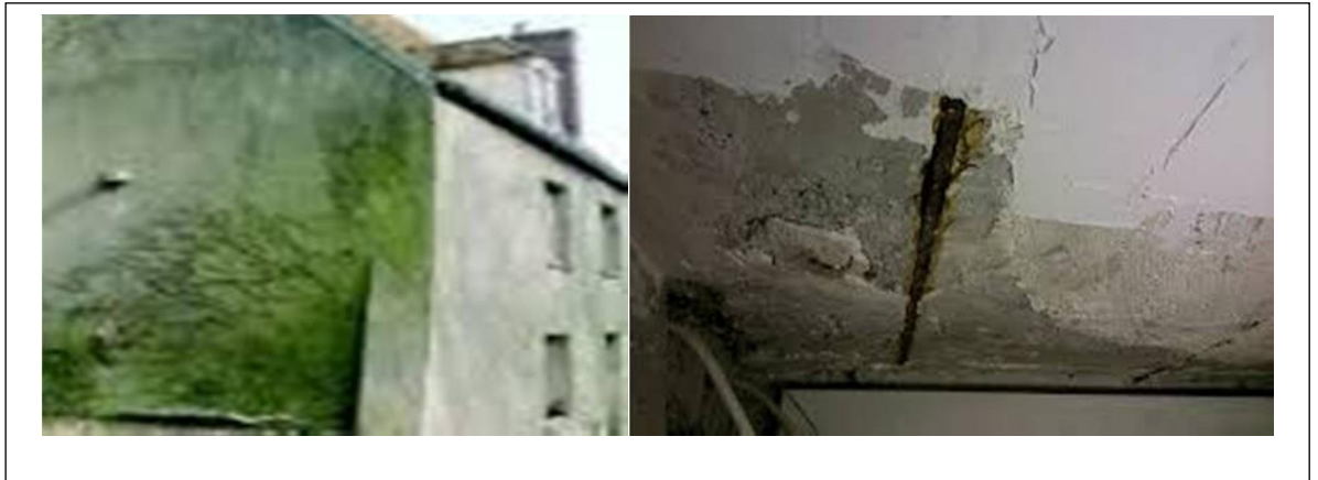
Figure I-28 : Lichen sur la structure
