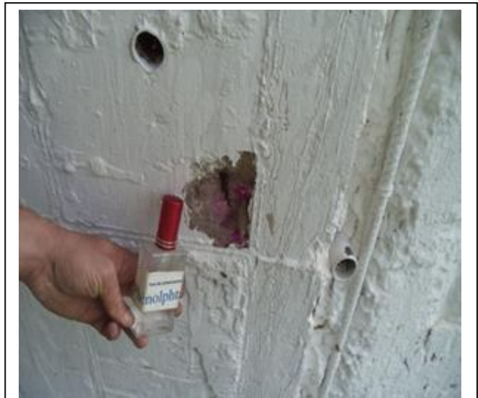
Mur de front de la culée « nord » carbonatation superficielle.
