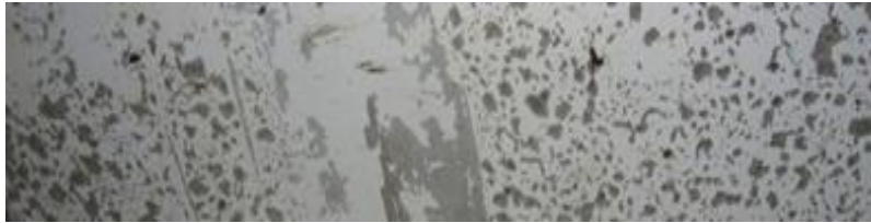
Figure I-7 : Dégradations dues aux sels de déverglaçage
