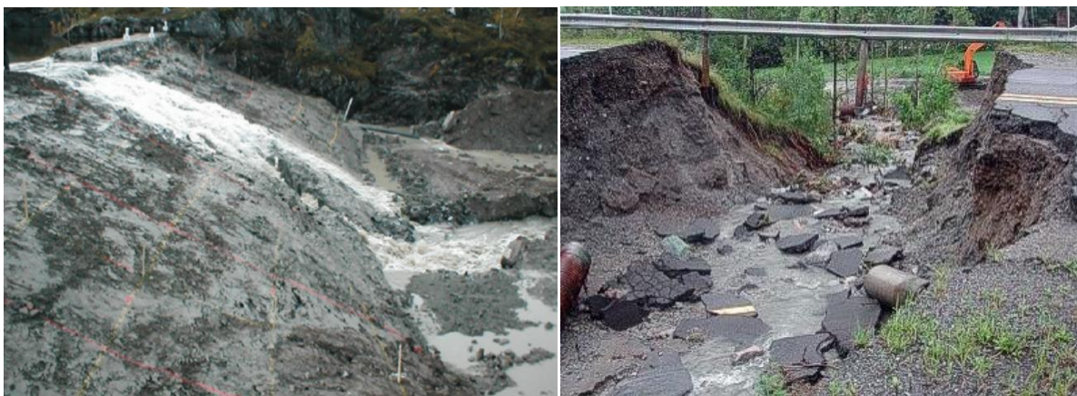
Figure 24: Phénomène d'érosion dans les remblais
