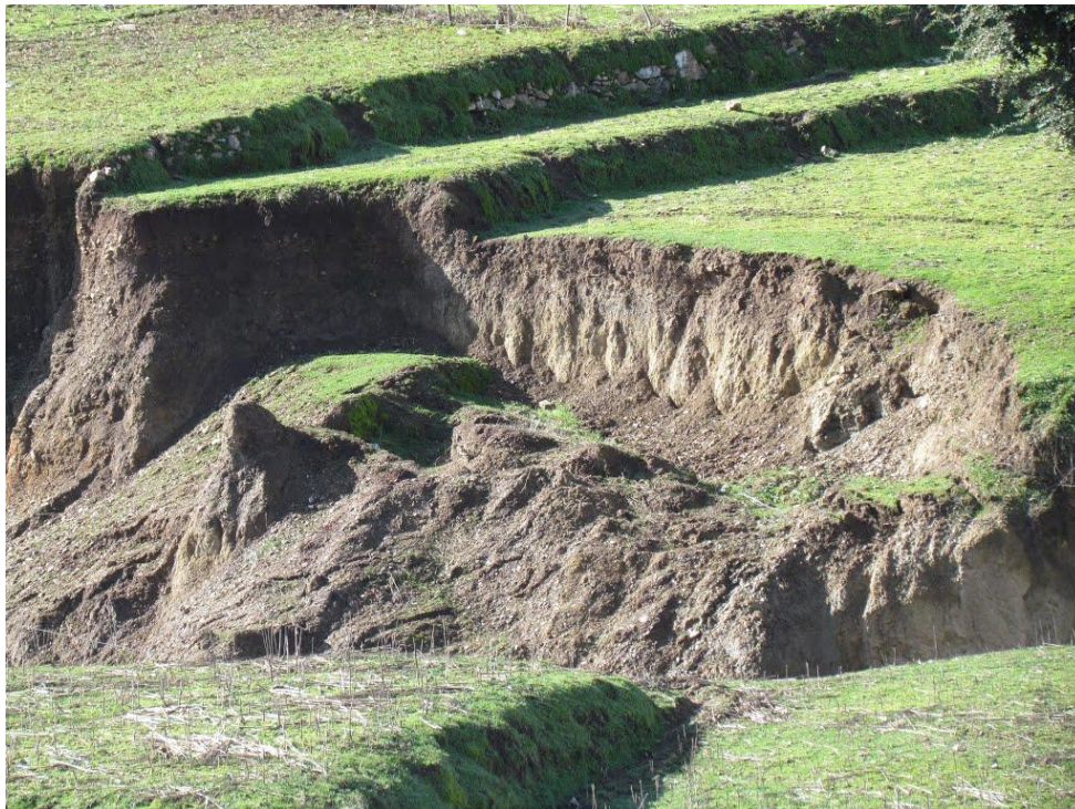
Figure 8 : Erosion en masse
