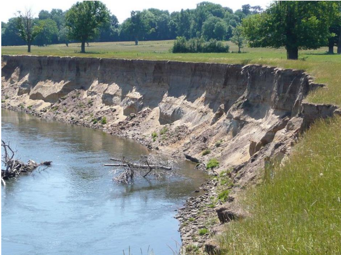
Figure 9 : Erosion des berges
