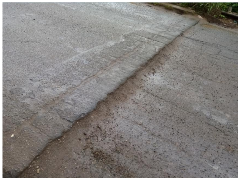
Figure 18 : Tassement dans le corps de remblai
