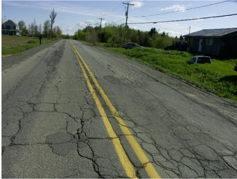
Figure 17 : Retrait-gonflement des couches compactées
