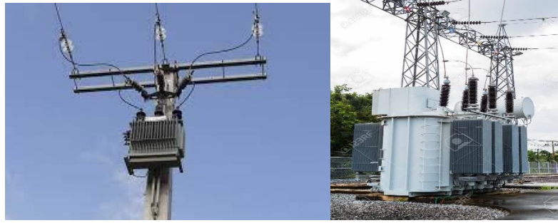
Figure I.2 : Les postes de transformation
