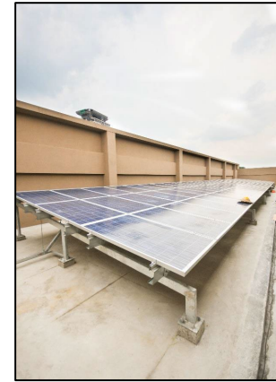
Figure 109 Panneaux Solaires sur le toit Source : http://khimmy.smugmug.com/Architecture/
