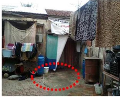
Figure.42 : Détérioration du pavage au niveau du patio Source : Auteure 2020
