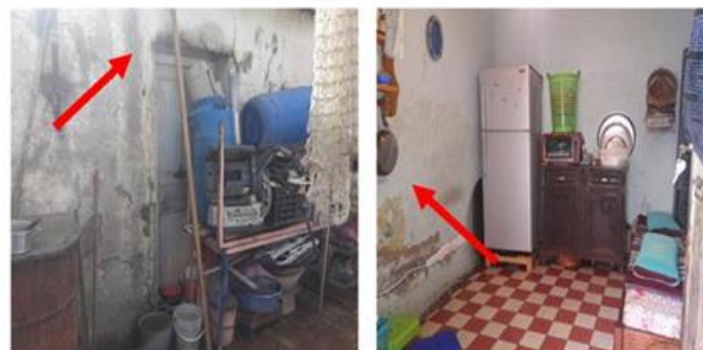
Figure 58 : L'humidité au niveau des murs du patio et la cuisine Source : Auteure 2020
