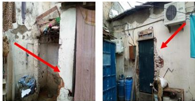
Figure 57 : L'état de dégradation des enduits au niveau maison Source : Auteure 2020
