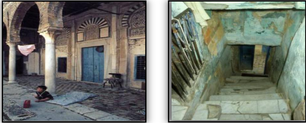
Figure. 23 : L'état de dégradation d'une des Oukala de la médina de Tunis.
