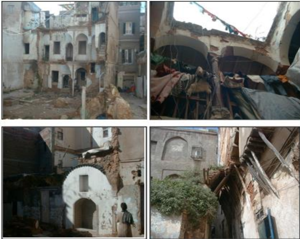
Figure. 34 : L'état des maisons du quartier Amar Ali de la Casbah d'Alger. Source : CNERU 2007.
