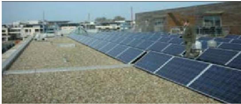
Figure 47: Intégration des capteurs en toiture terrasse.
