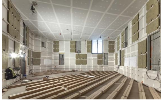
Figure 71 : Les plaques fermacell Source : https://www.lemoniteur.fr/photo/philharmonie-paris.842649/4-philharmonie-paris.4
