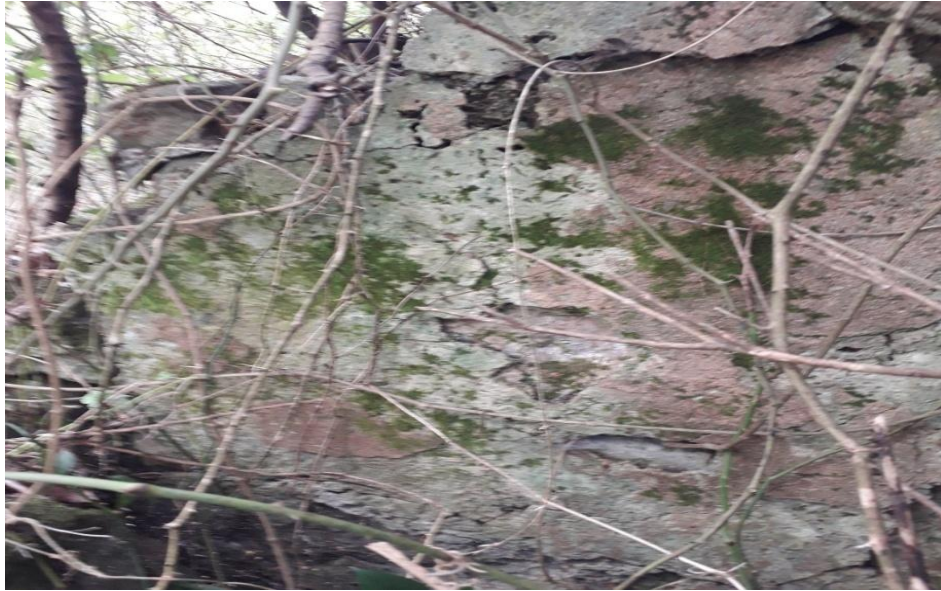
صورة رقم 37 تظهر تأثير الطحالب
