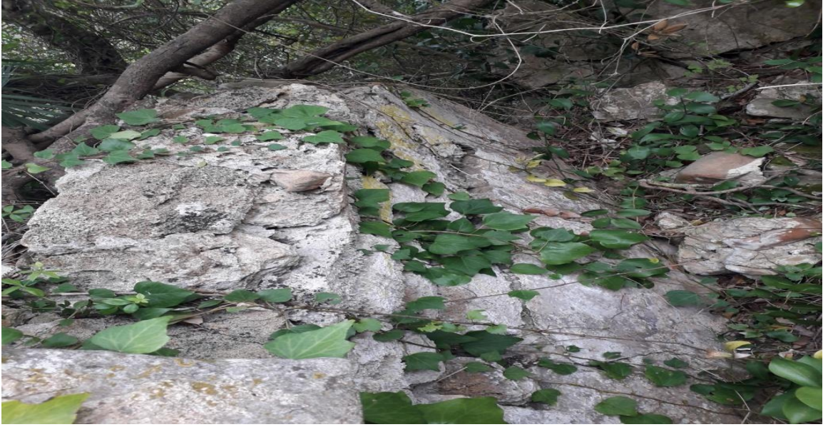
صورة رقم 43 تظهر تصدع وتكسر الواجهات والجدران
