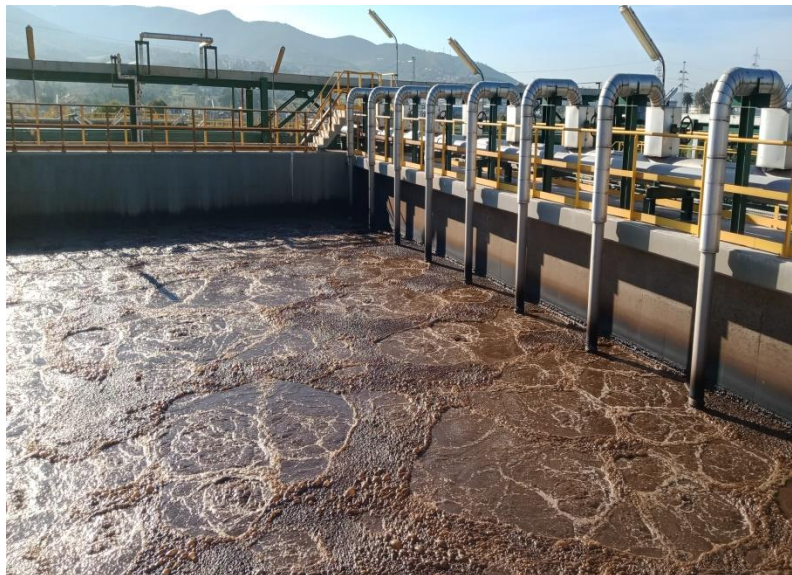
Figure 14 : Bassin du traitement biologique.
