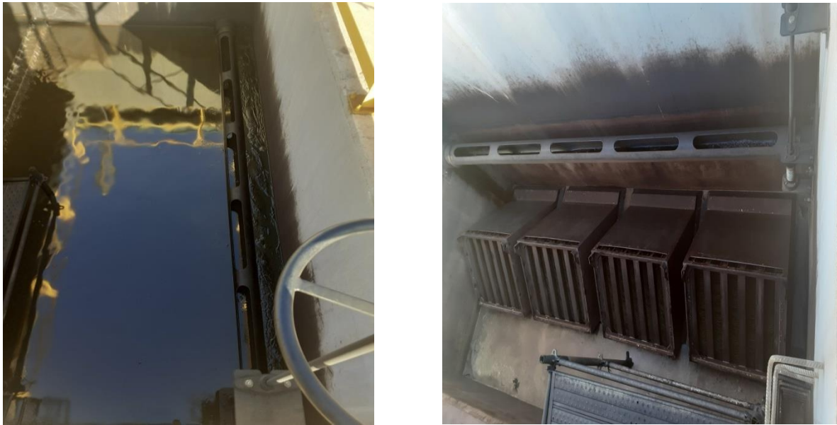
Figure 9 : Bassin de déshuilage (API).
