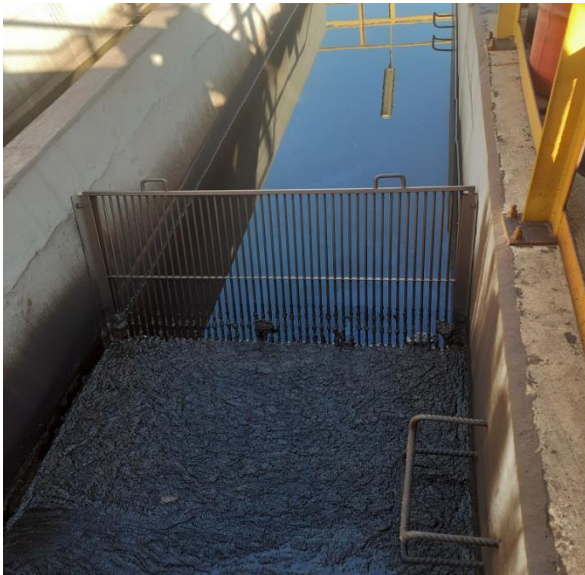
Figure 4 : Dégrillage et dessablage
