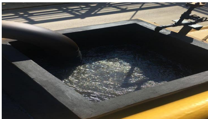
Figure 12 : Bassin de floculation.
