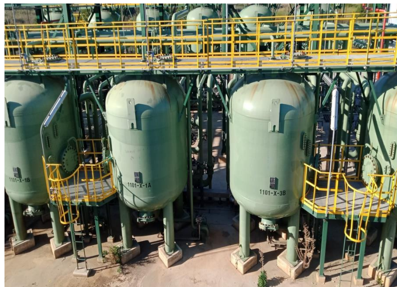
Figure 15 : Les filtres à charbon et à sable.
