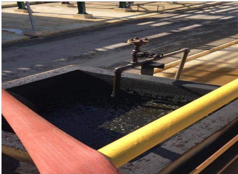
Figure 10 : Bassin de coagulation (Mixage rapide des eaux).
