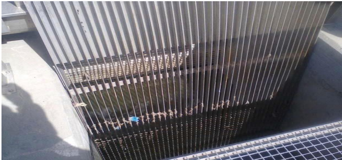
Figure II.3 : dégrillage STEP Guelma
