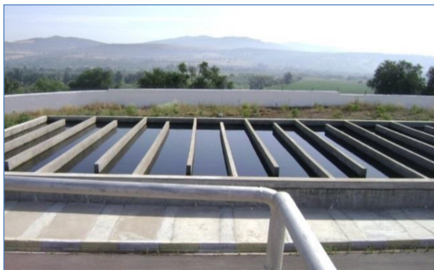
Figure II.8: Bassin de désinfection
