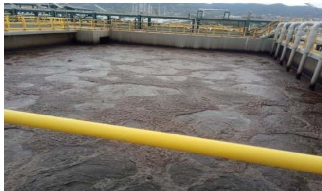
Figure II.8 Bassin de traitement par boue active TN6
