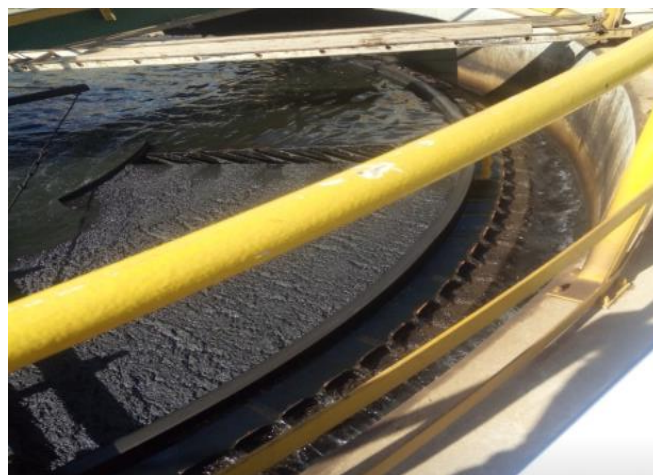
Figure II.5: Bassin de flottation à air dissout TN-4A
