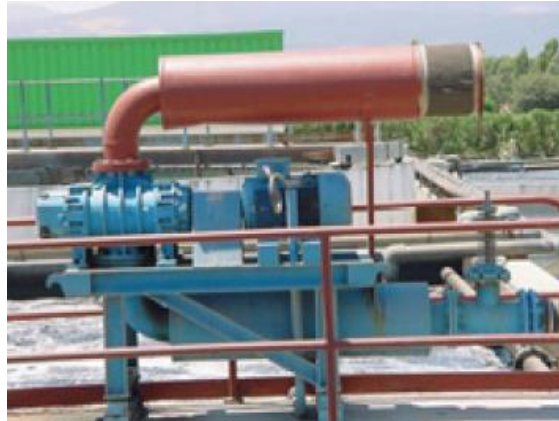
Figure III.10 : Surpresseur d'air dans un bassin aéré
