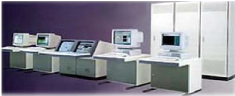
FIGURE 3.13 – Vue de la salle de contrôle (stations HIS)
