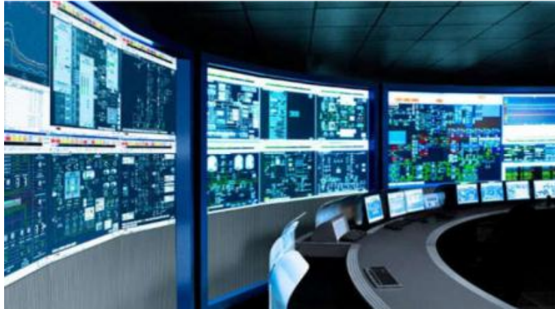
Figure 2.4. Poste de pilotage muni d'un système SCADA
