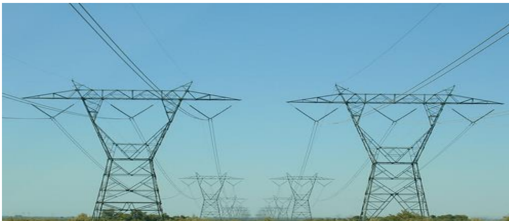
Figure II. 1: 745 KV ligne de transmission avec tours en treillis autoportantes.
