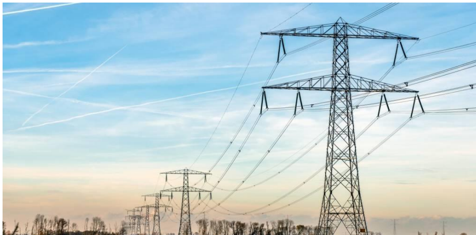
Figure I. 5: Réseau HTA aérienne.
