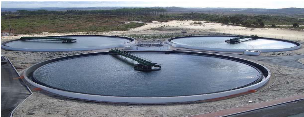
Figure .IV.12 : Décanteur secondaire «clarificateur».
