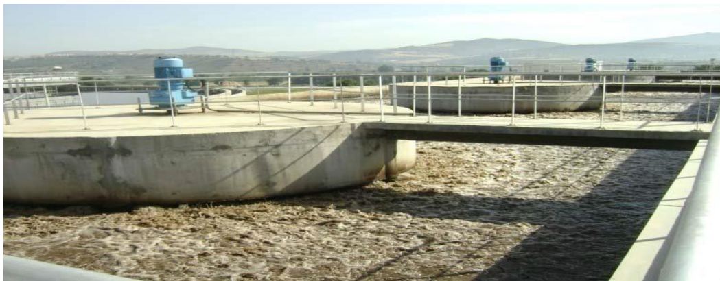
Figure .IV.6 : Bassin de traitement biologique.
