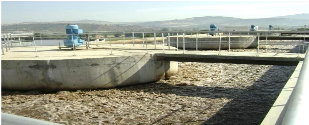
Figure.V.7 : Bassin de traitement biologique (STEP Guelma). [26]
