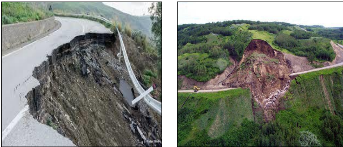
Figure 2.1 Glissements de terrain
