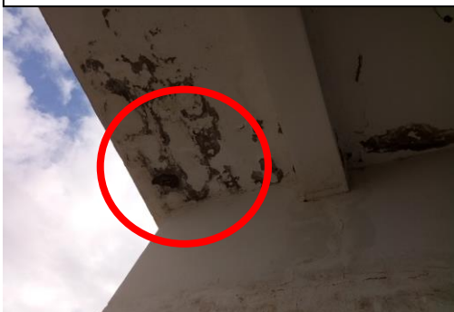
Figure 28 : Plafond des couloirs « CEM Taher Zeghdoudi Guelma »
